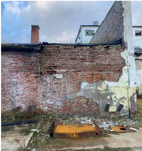
Bild på fasadens västra långsida. Stora skador i fog och puts.
