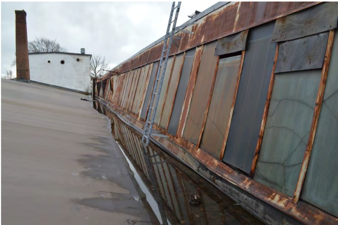
Bild på taket. Synligt rostangrepp på partierna. Vattenansamling vid lågpunkten på sågtandstaket, takavvattningen fungerar ej. Obs! Bilden är 5år gammal, det befintliga läget är med all sannolikhet betydligt värre.
