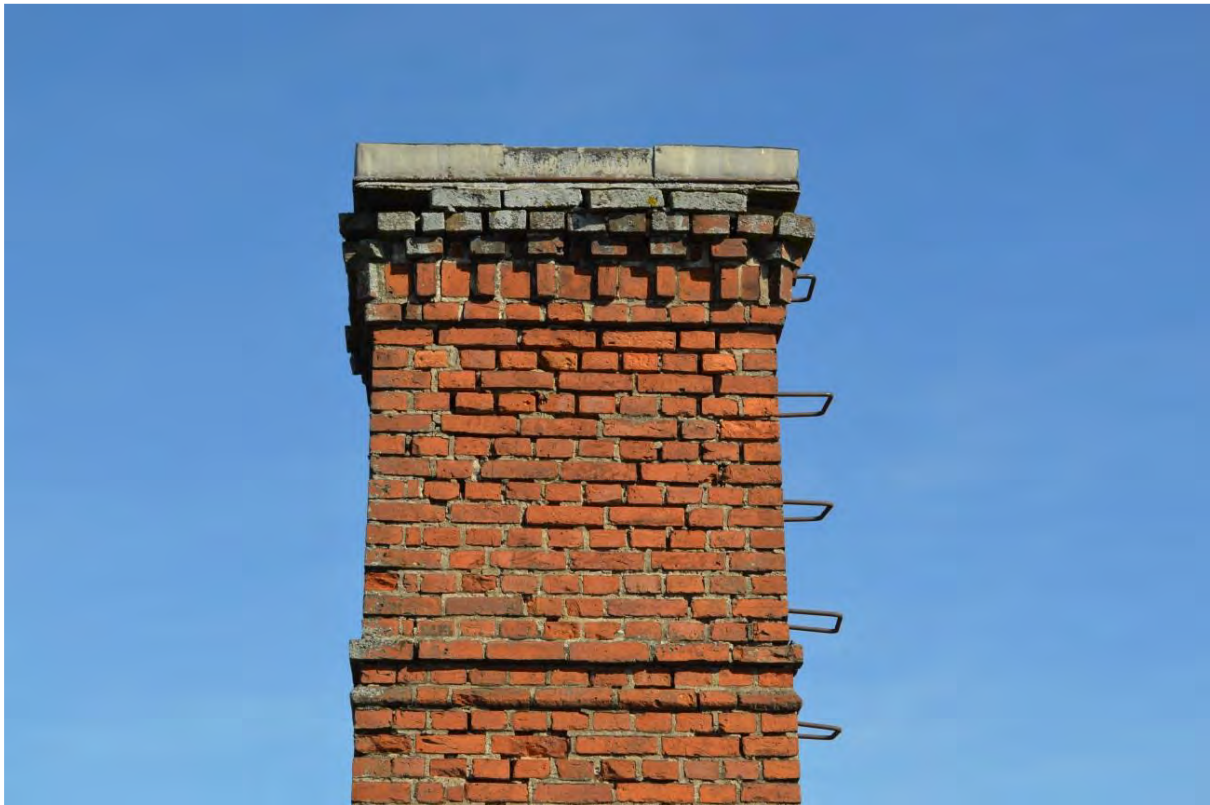
Bild på skorsten. Stora brister i fogen och en del söndriga tegelstenar.
