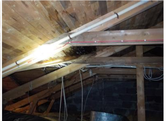
Läckage vid rännedal mot den södra innergården.
