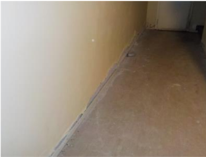
Limmad plastmatta, golvlister och färg- och putssläpp på nederdel vägg i anslutning till krypgrund i den västra delen av källaren.
