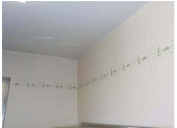
Färgsläpp i tak och vävsläpp på väggar i städ/diskutrymme.
