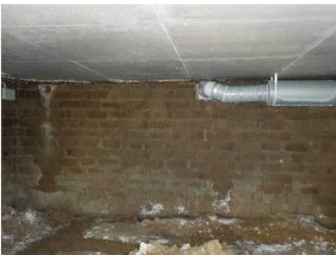
Västra grunden: Kondens på undersida betongvalv i den västra delen.
