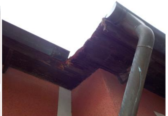
Läckage/rötskador i takkonstruktion vid innergården.
