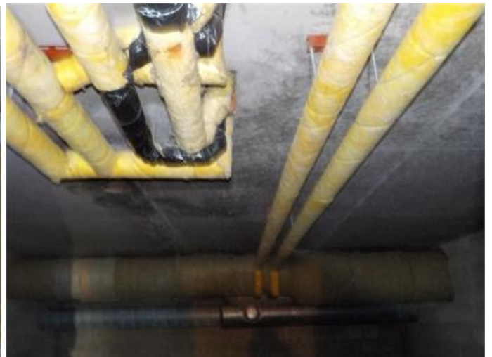
Missfärgning efter troligen läckage i undersida betongvalv i den norra delen.
