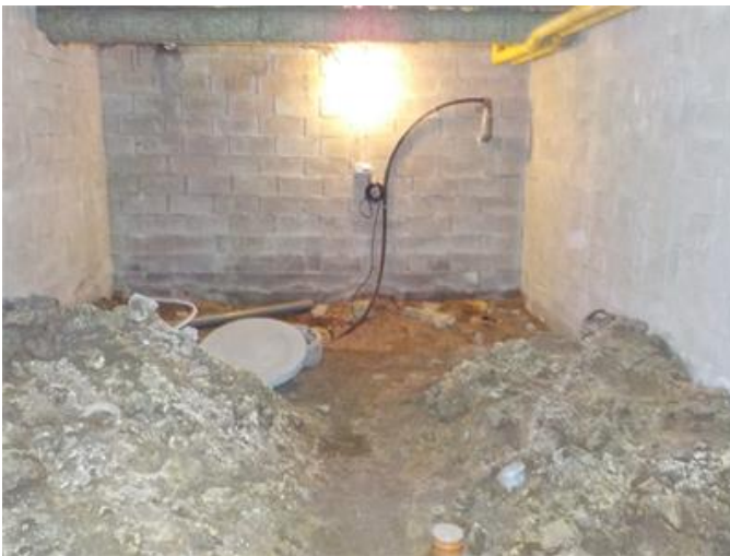
Bild på den norra delen med pumpbrunnen.
