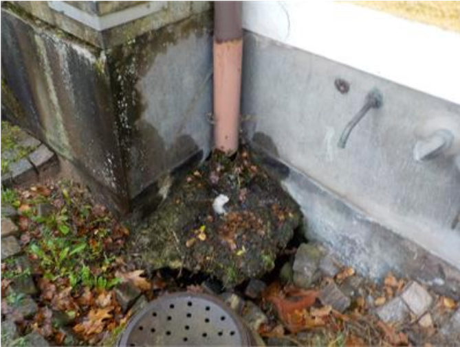
Sättning i marken där dagvattenledning är sönder i anslutning till huvudentrén.
