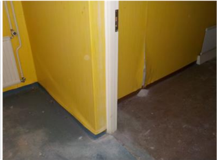
Ytskikt som har släppt från underlagen i den västra delen av källaren.
