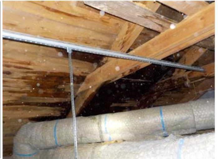
Större läckage i sydöstra delen av "förskolans" vind.
