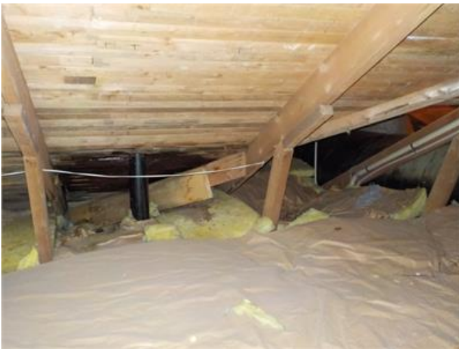
Läckage vid rännedal mot den södra innergården.
