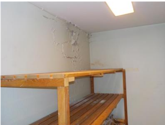
Färgsläpp och förhöjda fuktvärden på ovan del vägg mot anslutande städ/diskutrymme.
