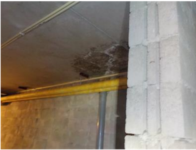
Mindre missfärgning efter troligen läckage i undersida betongvalv i den norra delen.
