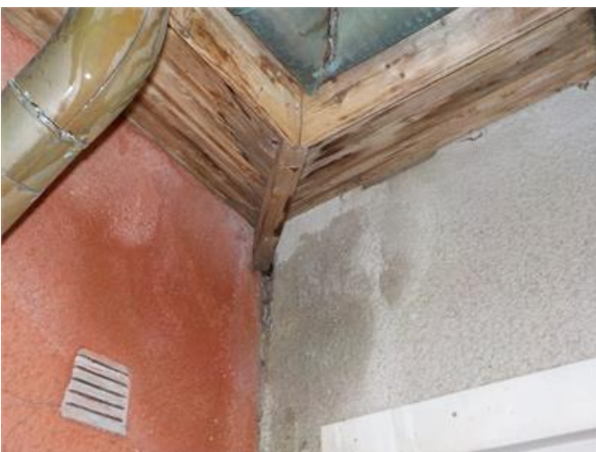
Läckagemärken i underlagstak/fasad vid rännal, södra innergården
