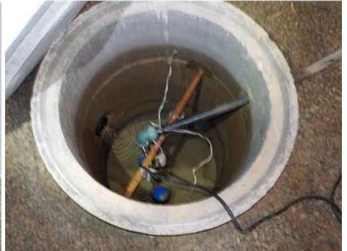
Vattnet står högt i den norra brunnen vilket tyder på att pumpen inte fungerar.
