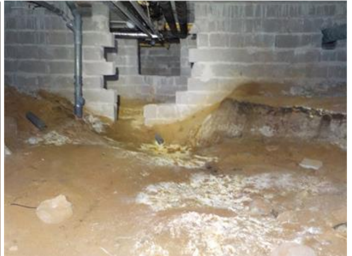
Mikrobiell påväxt på marken i den sydvästra delen sk. krypgrunden.
