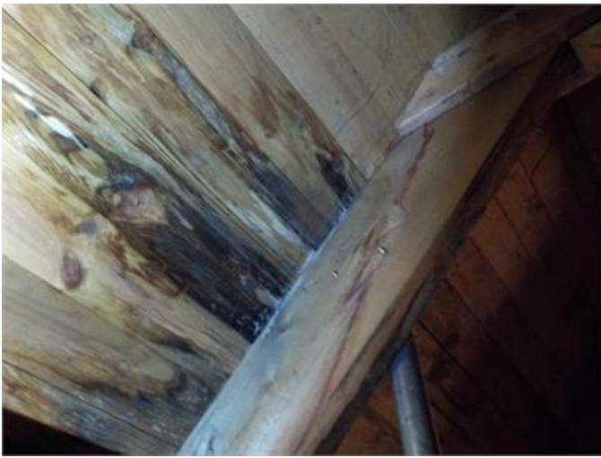
Läckage i anslutning till rörgenomföring i nockvinden (1½-plans byggnaden)
