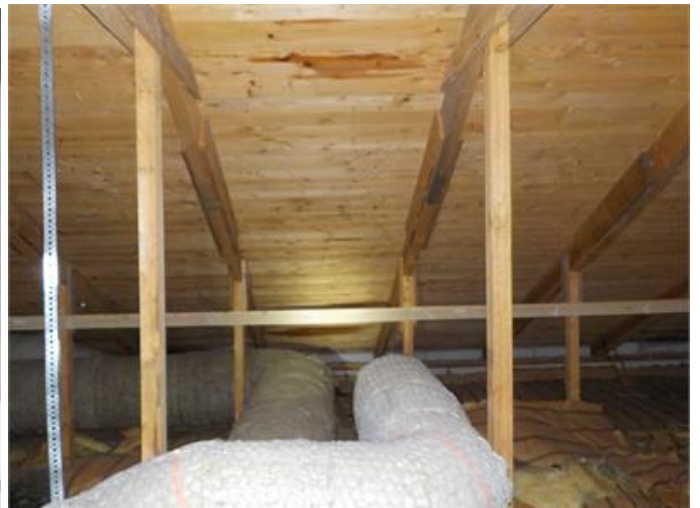
Läckage genom underlagstak i den nordvästra vinden (2-plans byggnaden)
