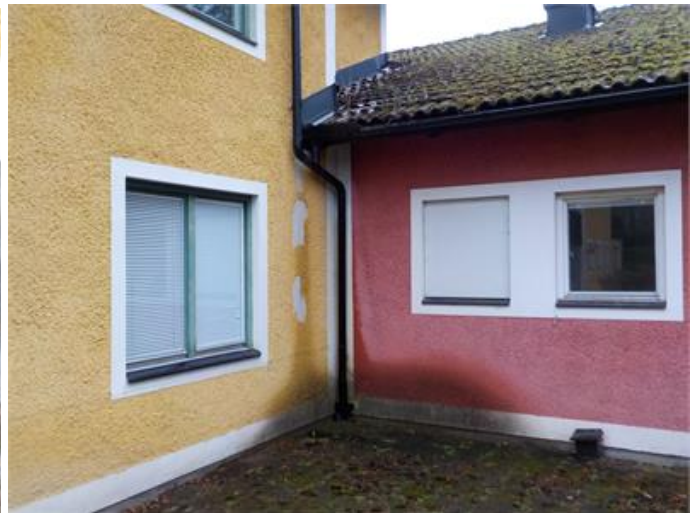
Färgsläpp och missfärgningar efter fukt på väggar vid altanen.
