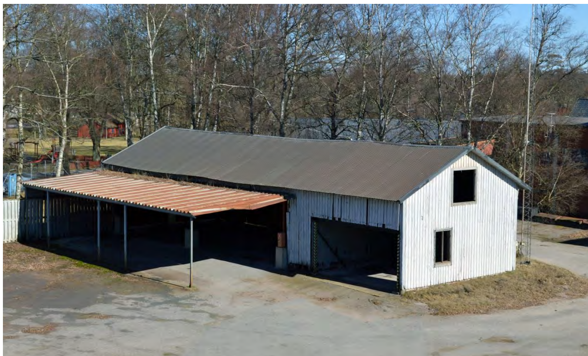
Magasinets västsida är fullständigt förvanskad med stora tillskapade portöppningar och ett utskjutande skärmtak. Åtgärderna har samtidigt skadat panelen.
