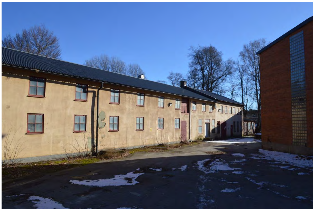
Modellförrådets västra långsida. Till höger om det närmaste stupröret syns den ursprungliga färgsättningen under det spjälkande färgskiktet. Innanför tegelgaveln till höger står smältugnen.
