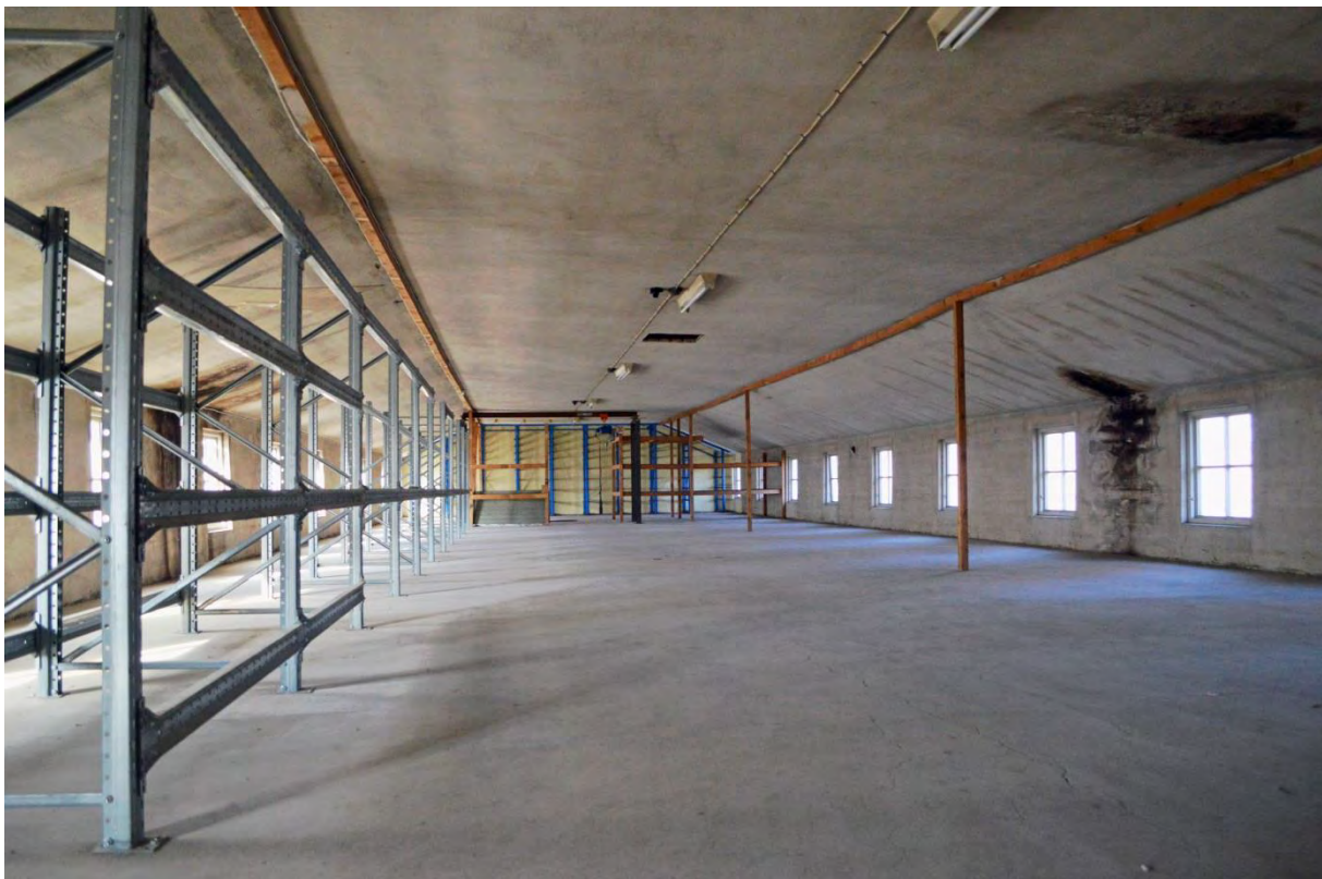
Andravåningens långsträckt lagerlokal. Till höger syns tydliga effekter av äldre fuktskador. I innertaket har sentida inspektionsluckor tagits upp.
